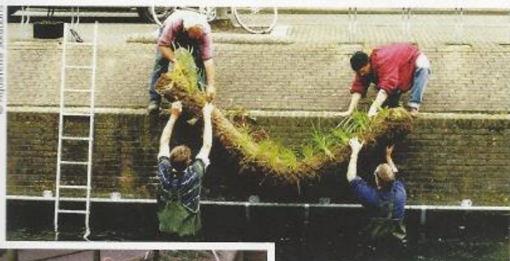
Pose de boudins végétalisés suspendus par des berceaux à une lisse fixée le long d'un canal urbain.
